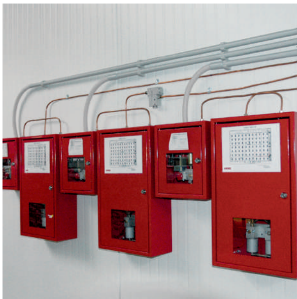
Rys. 1 Przykładowe zastosowanie pneumatycznych systemów sterowania oddymianiem
