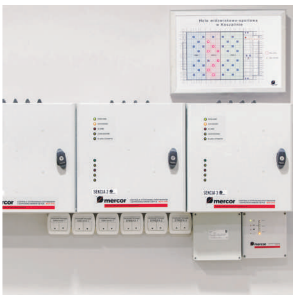
Rys. 2 Przykładowe zastosowanie elektrycznych systemów sterowania oddymianiem
